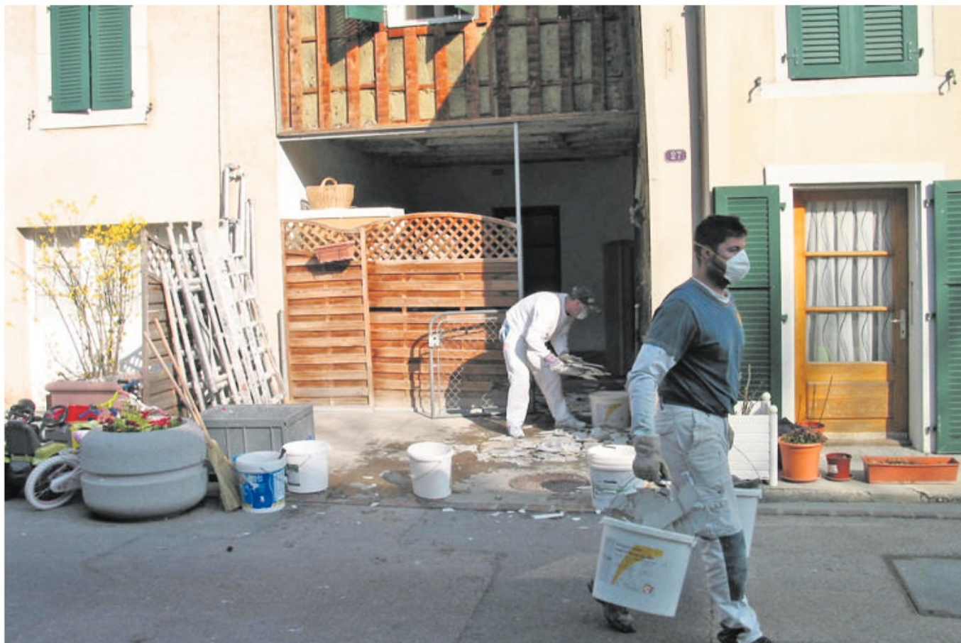
Munis de masques offerts par une voisine, les ouvriers évacuent des gravats qui contiennent de l'amiante. LDD
